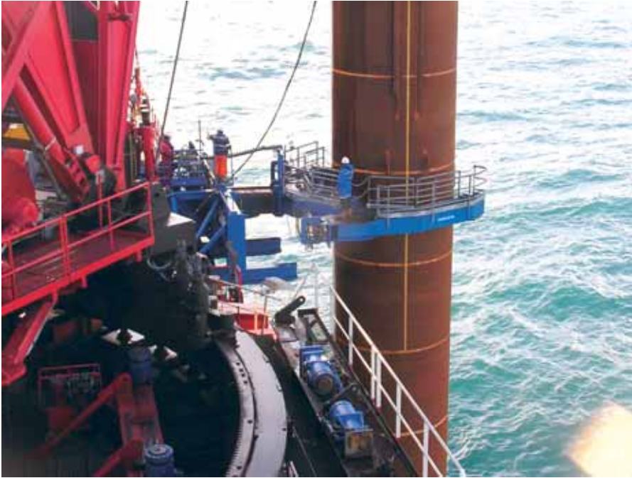
Paalua ollaan lyömässä merenpohjaan. Paalut ovat 50 tai 54 metriä pitkiä ja veden syvyys on 19-24 metriä.
